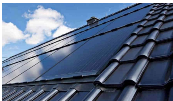
Zonnepanelen in het dakvlak
